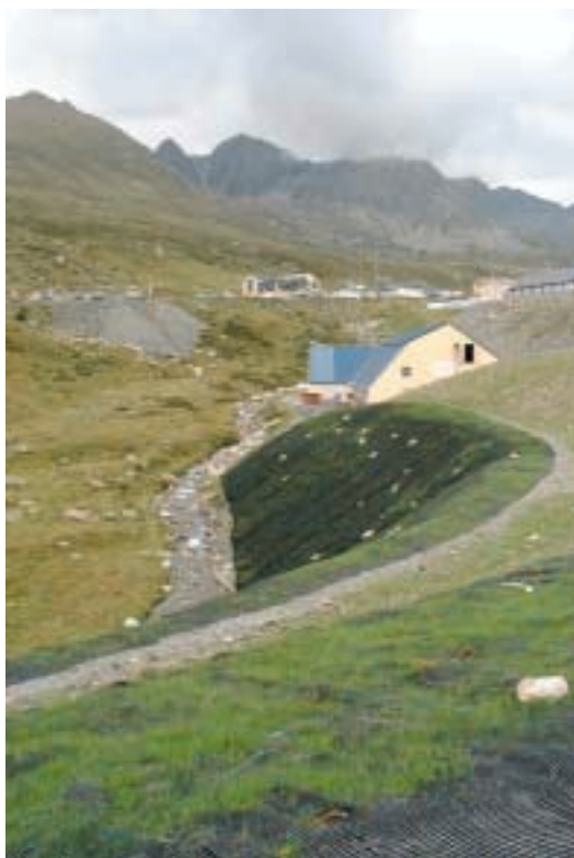
Talús amb geomalla, en què s'observa la germinació de les primeres plàntules. Pas de la Casa, agost 2002. Foto cedida per Euroconsult SA.
