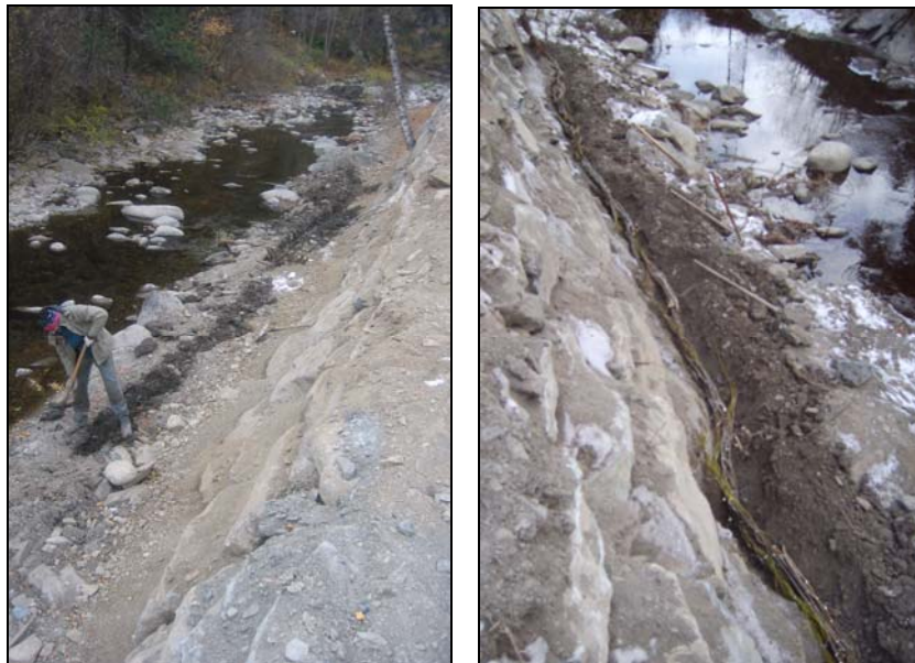
Fotografia 7.- Preparació de la rasa per a la col·locació de les feixines a Cal Pellissé de Canillo
