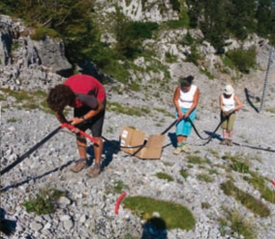
INSTAL·LACIÓ D'ESPIRALS PER VISUALITZAR ELS CABLES EN UNA ESTACIÓ D'ESQUÍ FRANCESA. E. MENONI, ONCFS
