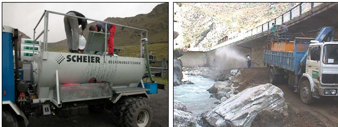
Fotografia 8.- Detall d'una hidrosembradora disposada sobre un vehicle 4x4 i treballs d'hidrosembra a la riba esquerra del Gran Valira al seu pas per Sant Julià de Lòria
